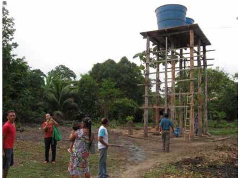
Neue Wasseranlage in Franca
